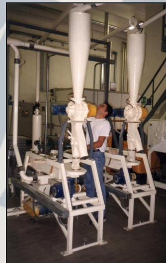
Ciclone di decantazione (CDP) Decantation cyclones.
